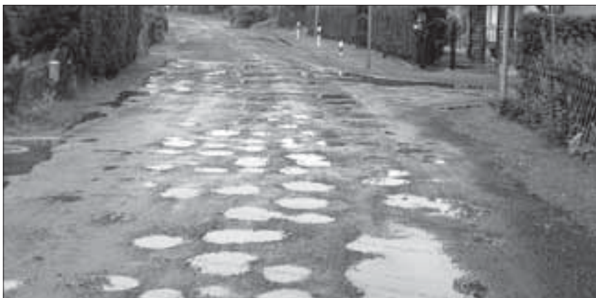
Zustand der Straße vor der Instandsetzung
